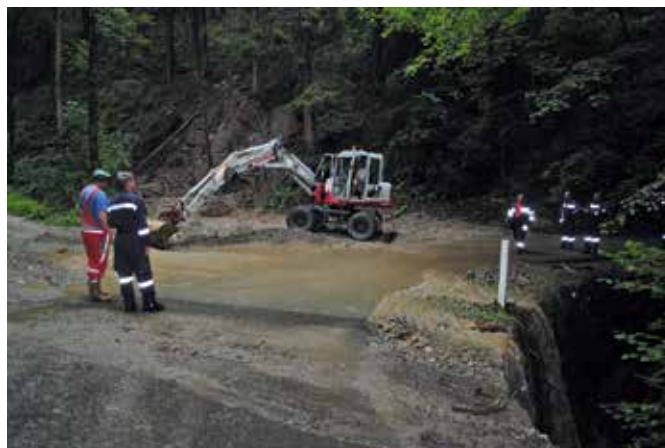
Aufräumarbeiten nach Unwetter vom 5.8.
